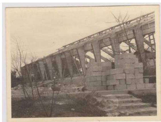
בניית חדר האוכל בשנת 1955. הוא הגיע בחלקים מקדמה והגדילו אותו לפי תוכנית של ביקלס
